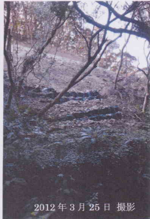
写真-8 処分場道路建設に伴う崩壊（修復済）
