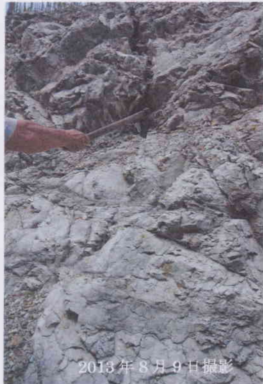
写真-3 開口亀裂の発達した西岬層
